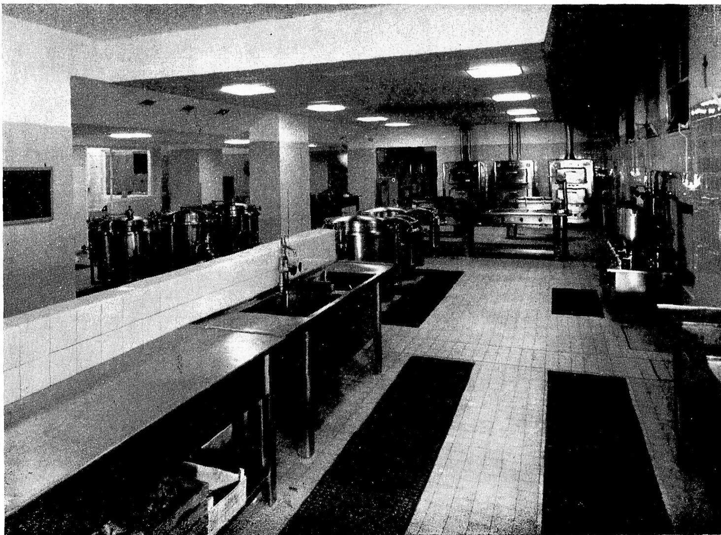
CUCINA DEL CENTRO TRAUMATOLOGICO INAIL DI PADOVA
