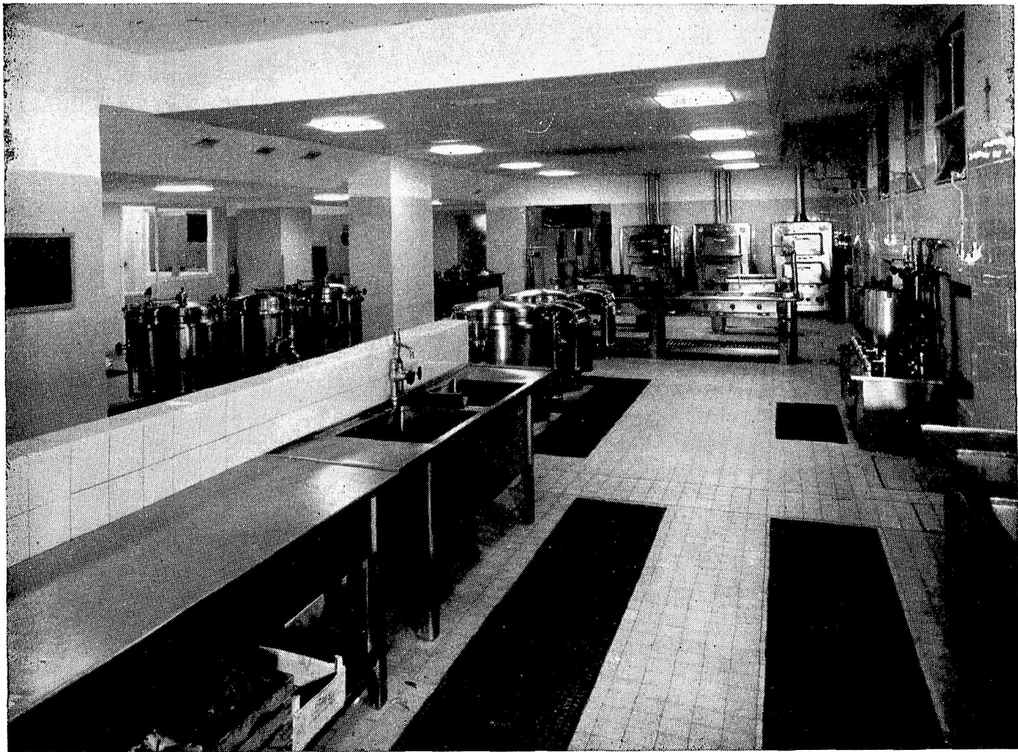
CUCINA DEL CENTRO TRAUMATOLOGICO I.N.A.I.L. DI PADOVA
