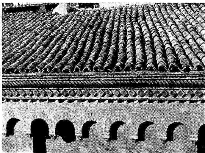
Padova - Palazzetto Bonafari - cornicione
