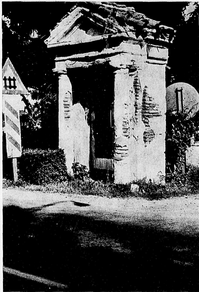
S. Giustina in Colle, contrada Palazzi, capitello demolito.
